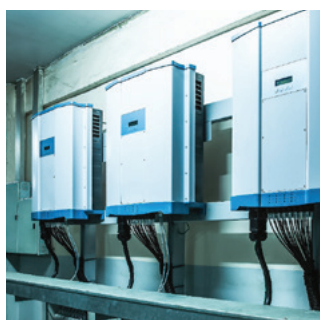
Sistemas de almacenamiento de energía fotovoltaica
